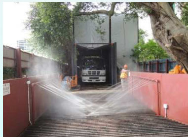
工地出口車輪清洗設施
